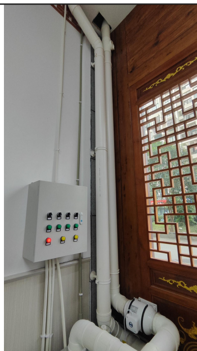
污水处理设备控制箱
