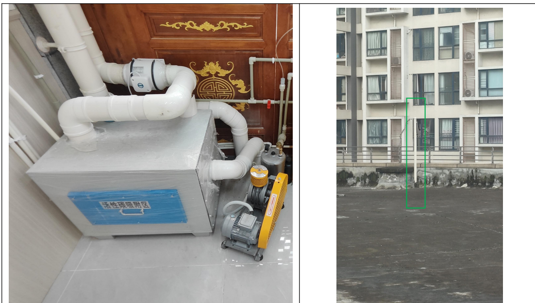
活性炭吸附装置及废气排口
