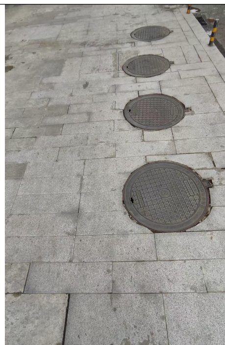
地埋式污水处理池
