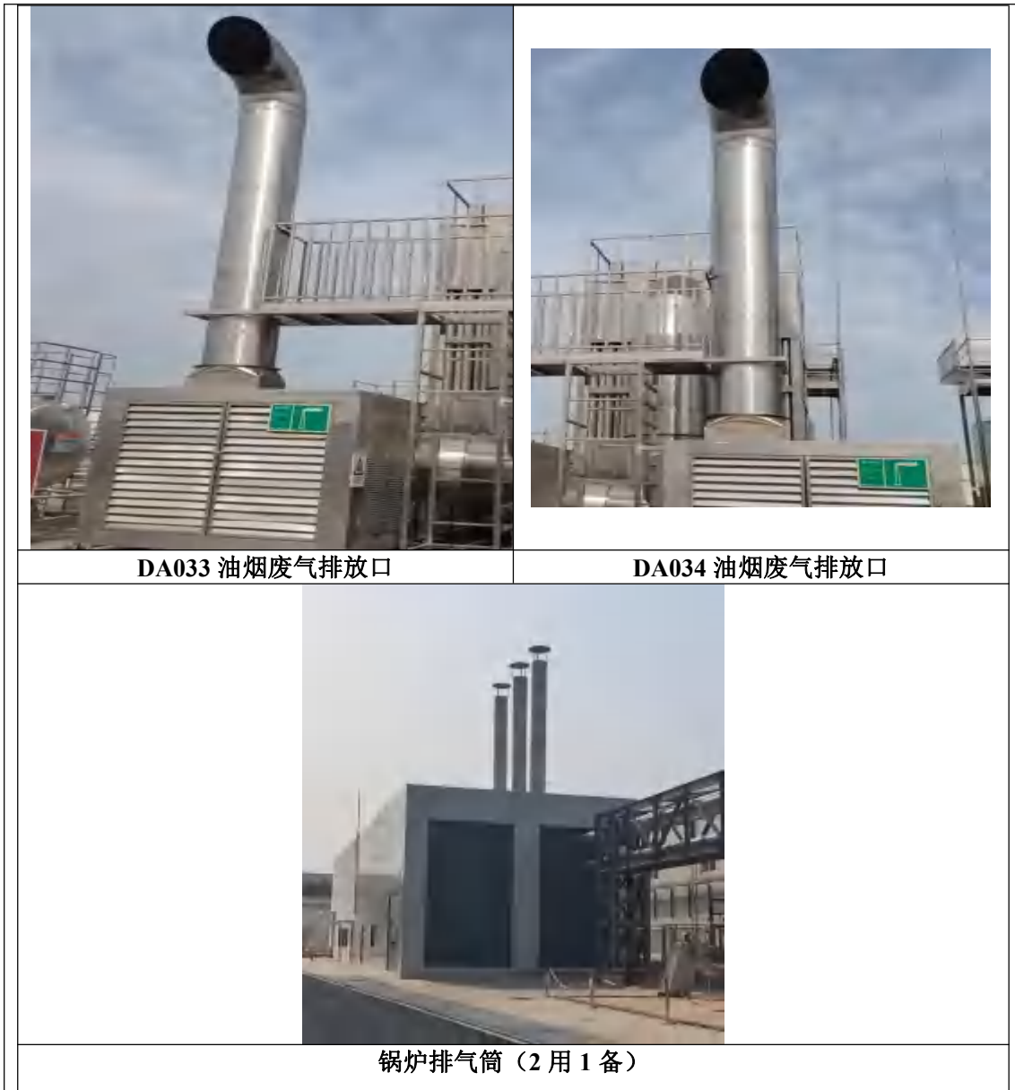
图 3-2 废气处理设施照片
