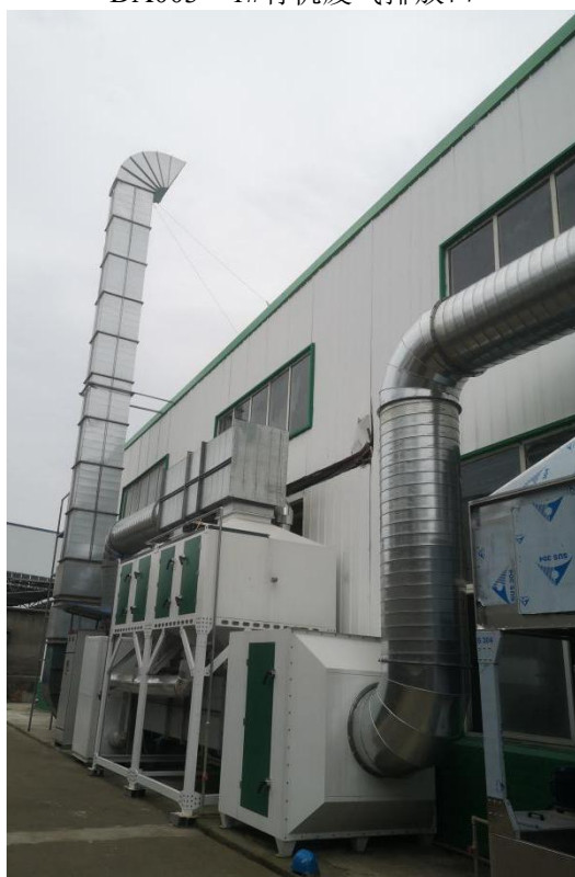
DA005 3#有机废气排放口
