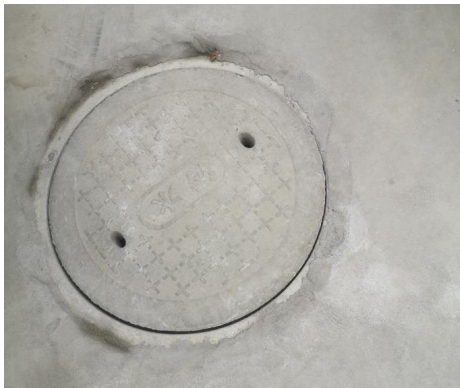
废水排放口（DW001）
