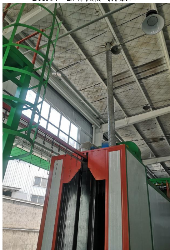
DA006 水份烘干炉废气排放口
