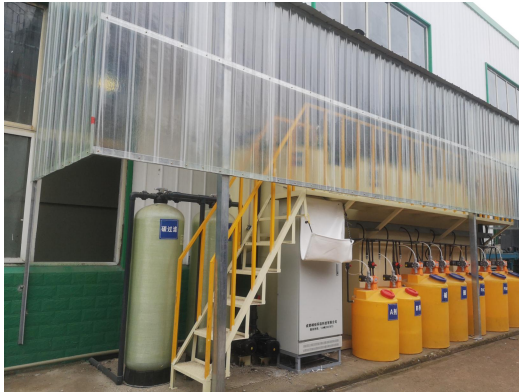
一体化污水处理站
