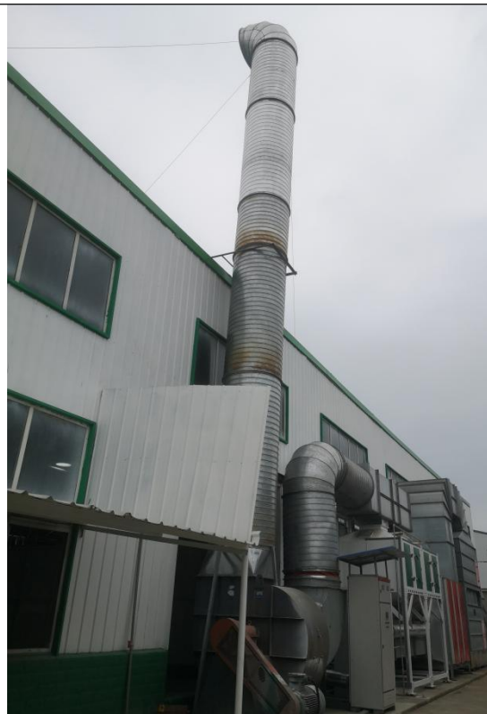
DA004 2#有机废气排放口
