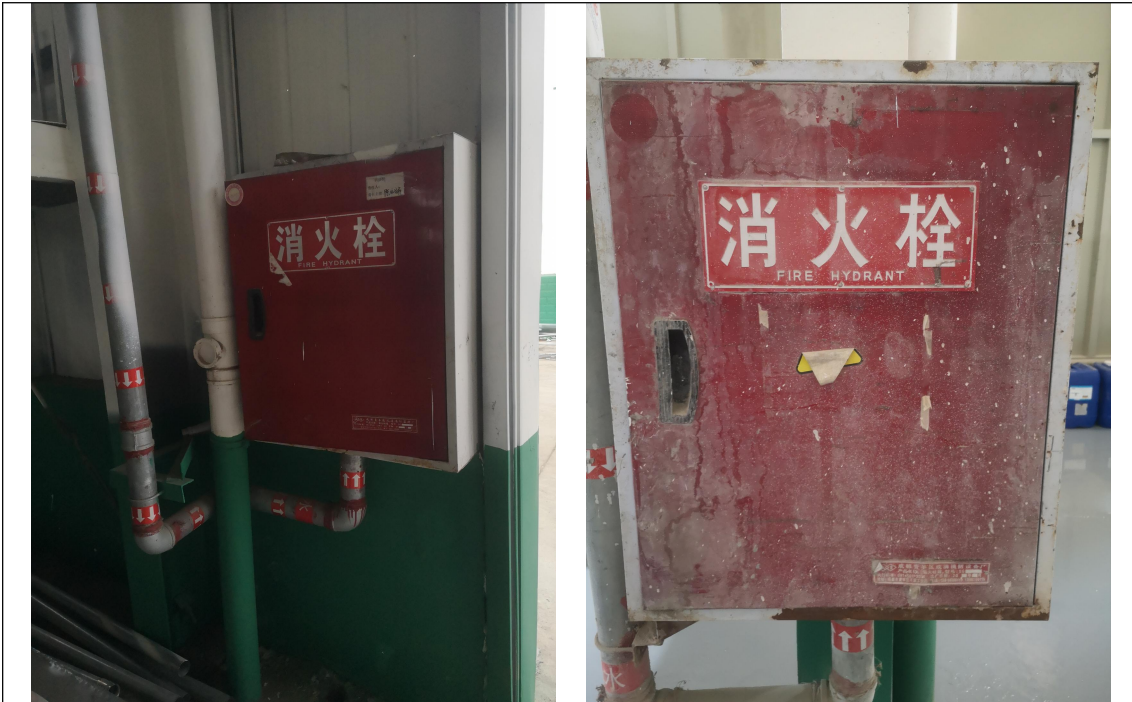
图 3-5 已设置消防设施
