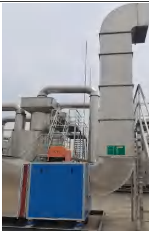
DA038 油烟废气排放口
