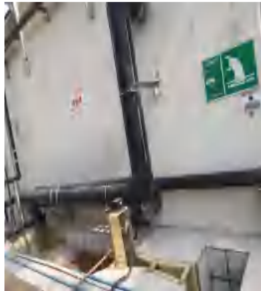
依托废水总排口
