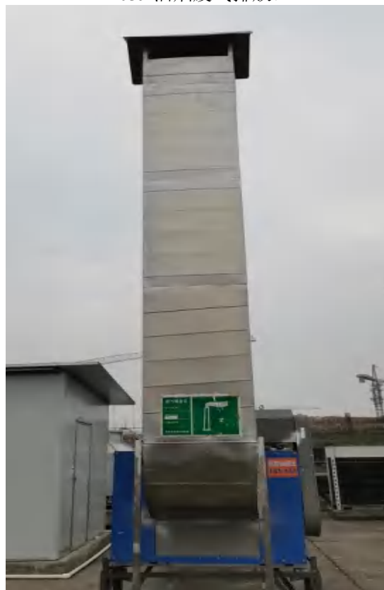
DA013 油烟废气排放口
