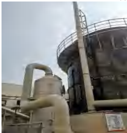
污水处理站碱水喷淋塔+过滤小球+活性炭 吸附装置
