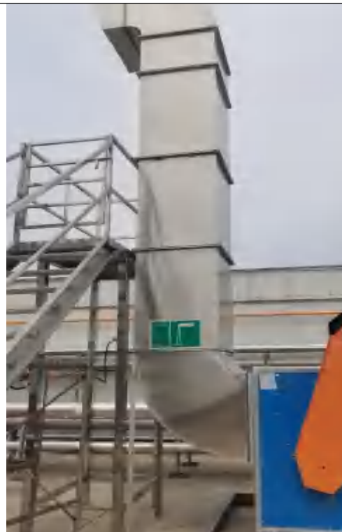
DA039 油烟废气排放口
