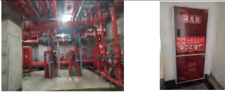
图 3-5 已设置消防设施
