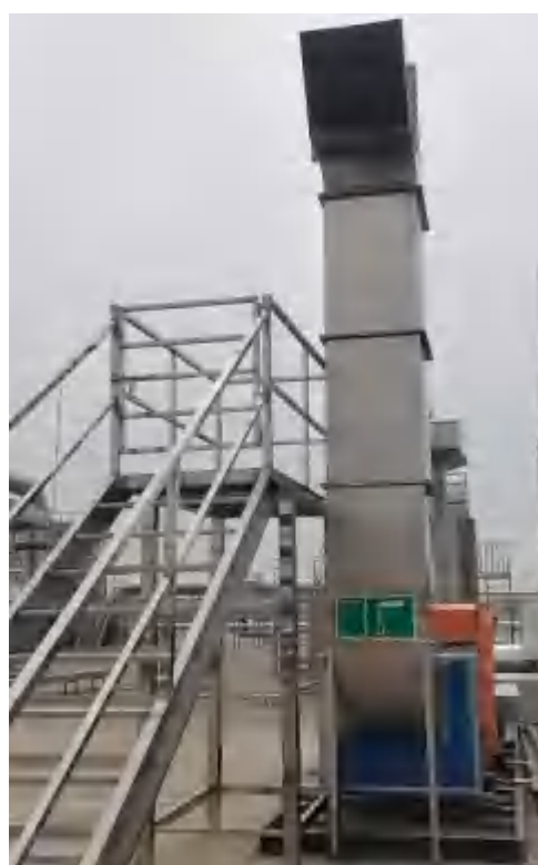
DA037 油烟废气排放口
