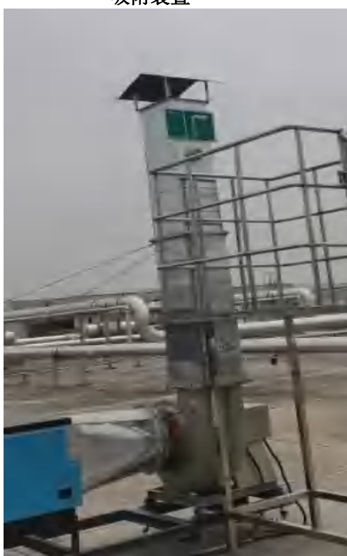
DA036 油烟废气排放口
