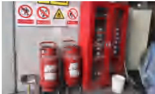
图 3-5 已设置消防设施
