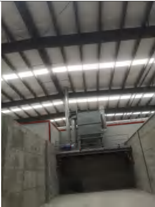
配料仓除尘装置及排气筒
