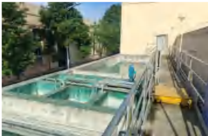
图 3-1 1#污水处理站照片
