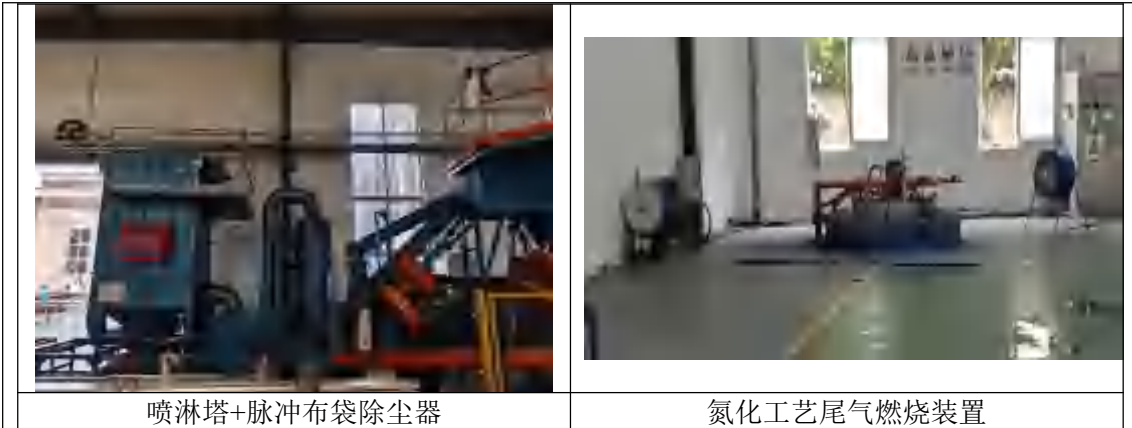
图 3-2 废气处理设施照片
