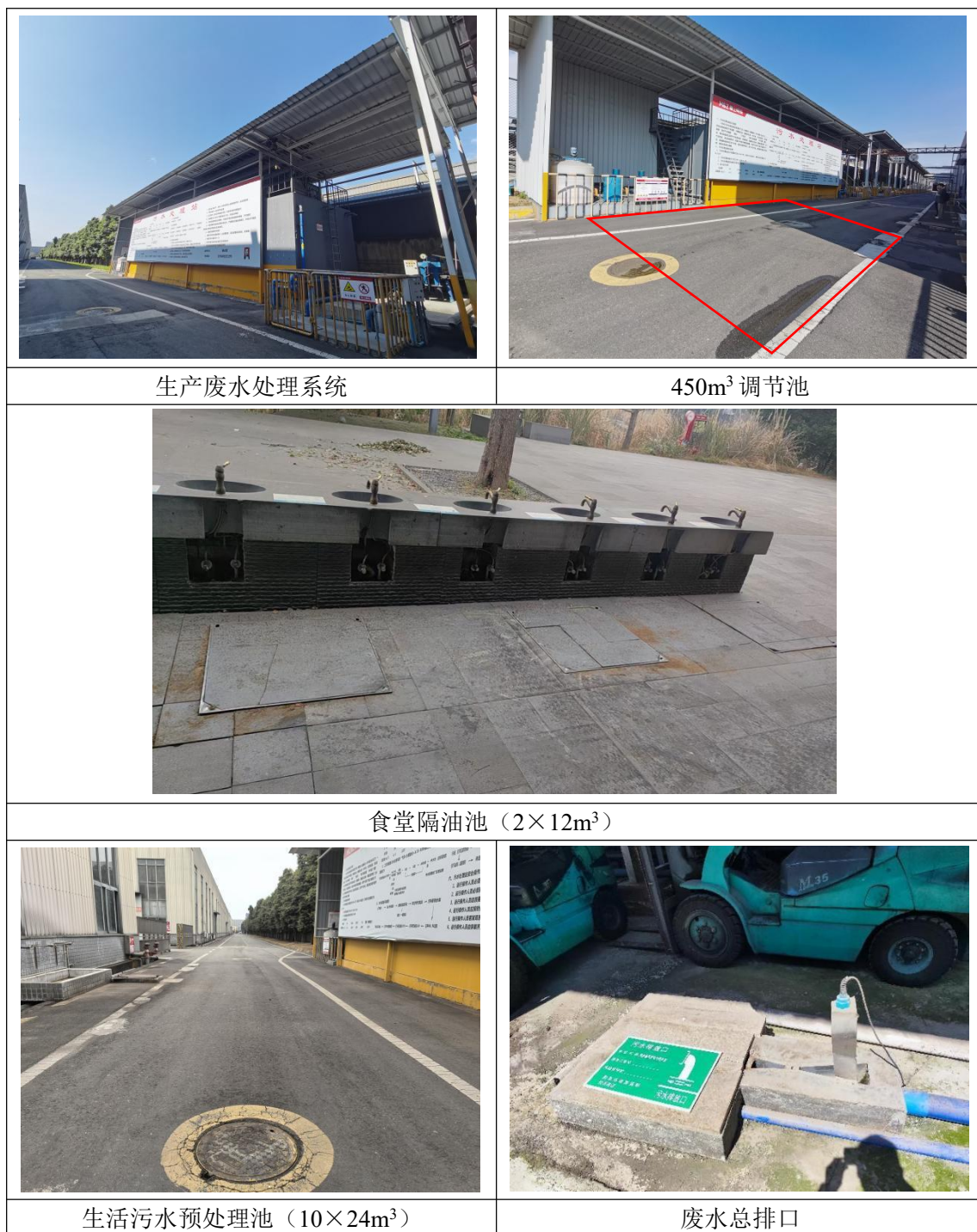
图 4.1-1 废水治理设施照片
