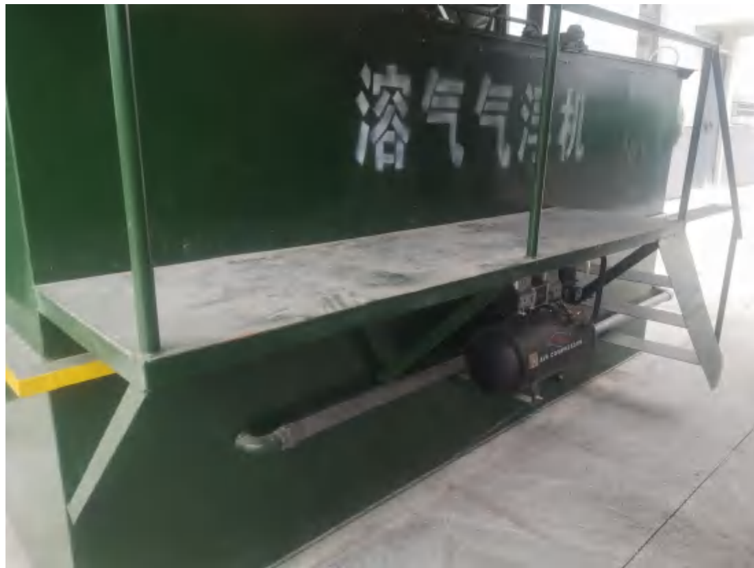
图 3-1 8#楼絮凝气浮装置
