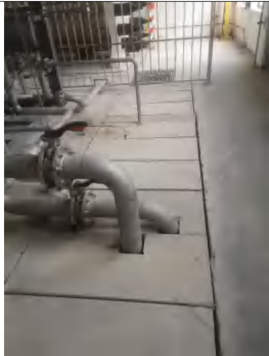
6#楼电解水制氢车间（制氢站）导流沟
