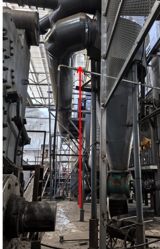
1#旋风除尘器+1#布袋除尘器+DA004 粉尘排放口
