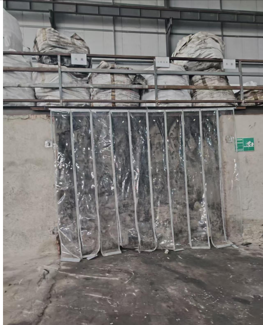
废油箱暂存间密闭
