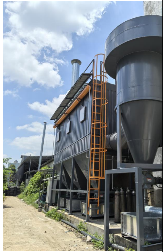
2#旋风除尘器+2#布袋除尘器+DA005 粉尘排放口
